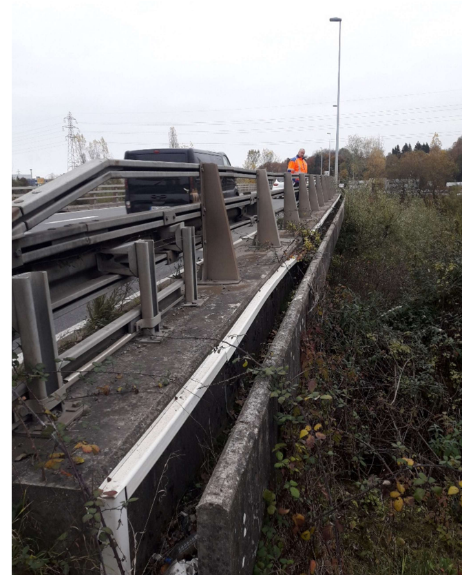
RD 1005 côté venue des eaux de la Dranse, PR 24-640 (5ieme pilier au niveau du personnel du Dpt 74)
