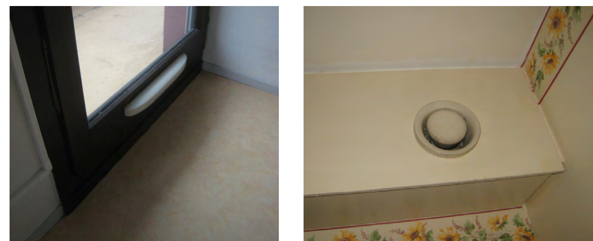
Images d'une entrée d'air mal placée en partie basse d'une porte (gauche), et d'une bouche d'extraction encrassée (droite)
