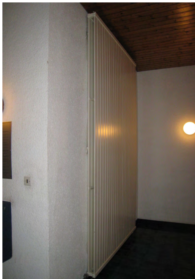
Images d'un radiateur hydraulique dans un hall d'entrée
