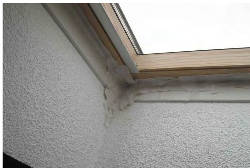
Image d'une fenêtre de toit non étanche et colmatée par un occupant (source MANASLU Ing.)
