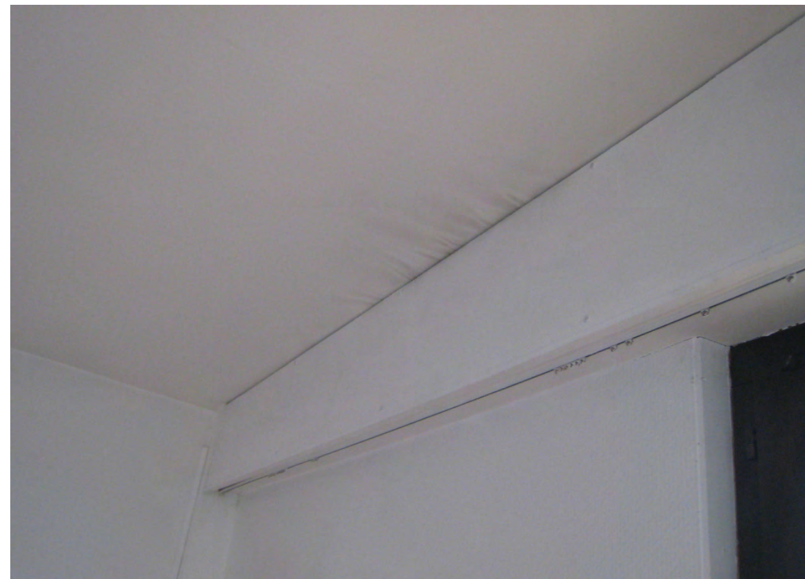
Image d'un coffre de volet roulant présentant défaut d'étanchéité à l'air
