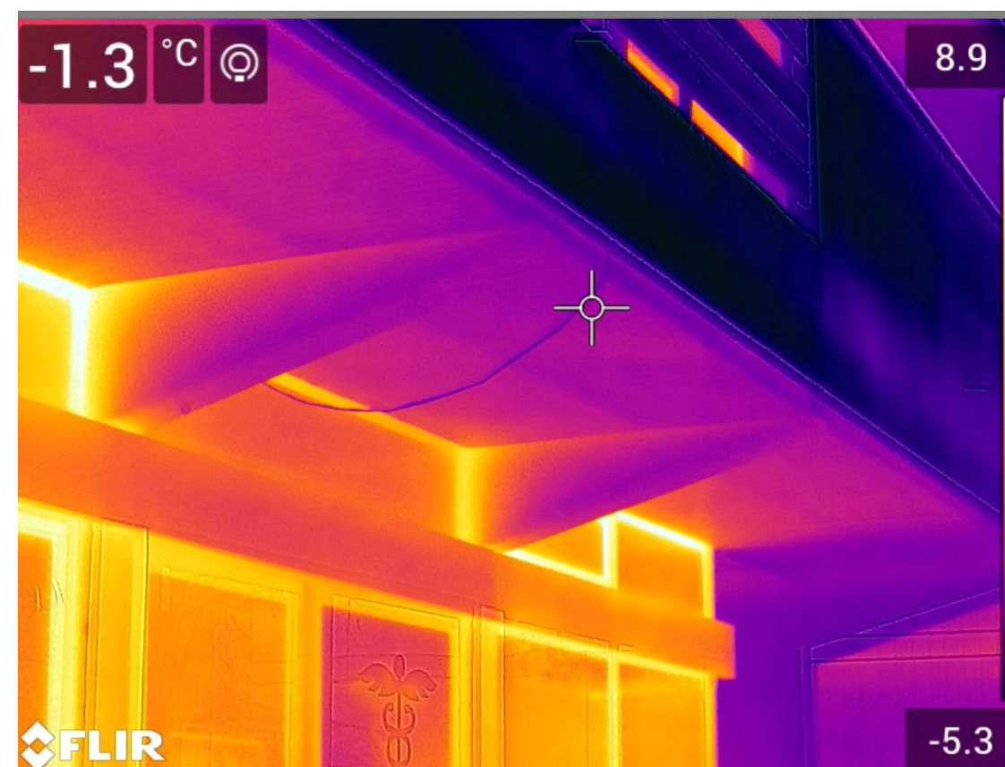
Thermographie d'une vitrine avec mise en évidence des faiblesses thermiques de la vitrine (source MANASLU)
