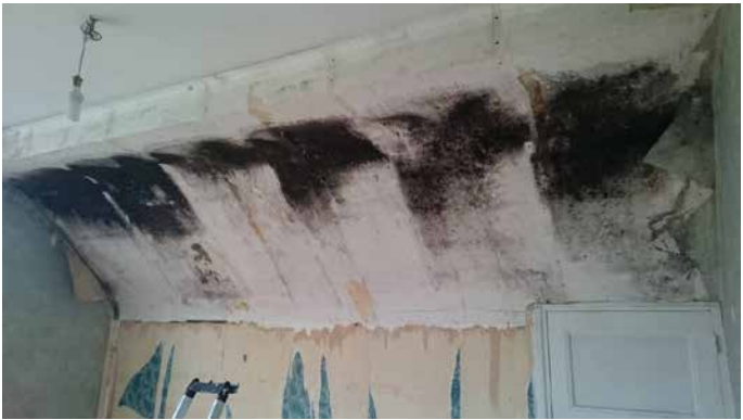
Image d'une face intérieure de toiture avec pose d'ITI sans pare-vapeur (source MANASLU Ing.)
