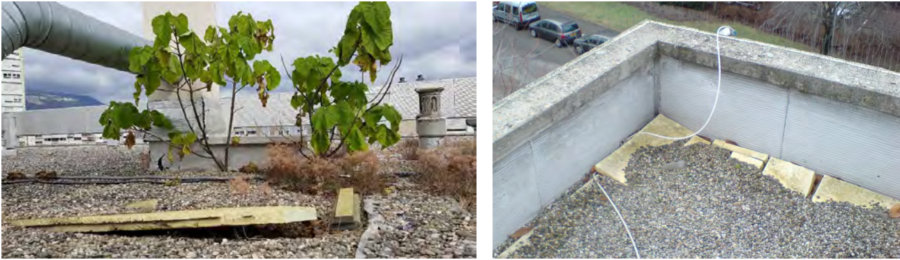
Illustration de dégradation d'une isolation inversée sur une toiture terrasse dégradée (source MANASLU Ing.)
