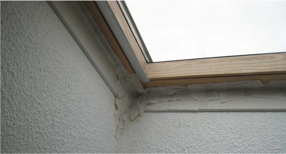
Image d'une fenêtre de toit non étanche et colmatée par un occupant (source MANASLU Ing.)
